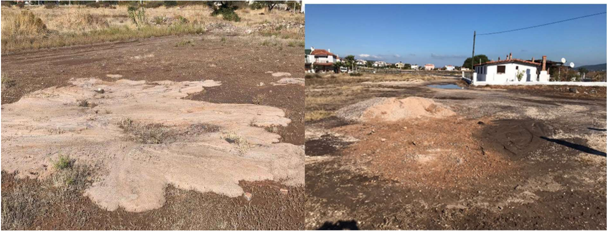
Şekil 4. Gülbahçe’de gözlenen sıvılaşma (kum kaynaması)
